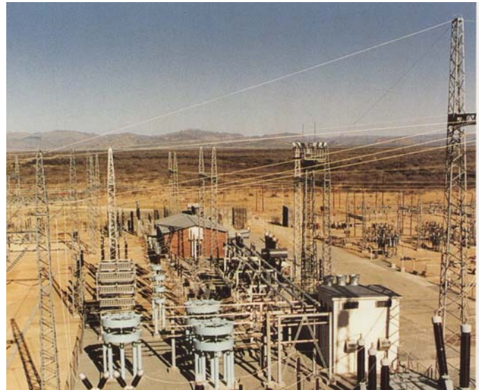
Umspannstation Omburu mit der Blindstrom-Kompensationsanlage der AEG. Die Anlage mindert die Auswirkungen von Störungen innerhalb des Stromversorgungsnetzes und trägt dazu bei, daß sich die Spannungsschwankungen bei der Energieversorgung nicht ungünstig auswirken
